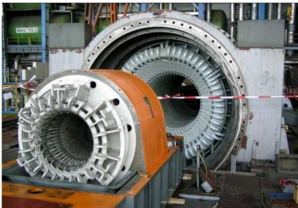
Obr. 6.5: Stator turboalternátoru a jeho budiče (elektrárna Dětmarovice)
