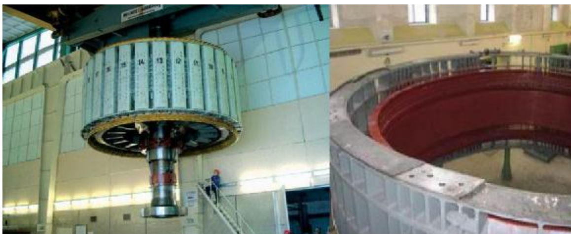
Obr. 6.3: Stator a rotor hydroalternátoru (VE Štěchovice)
