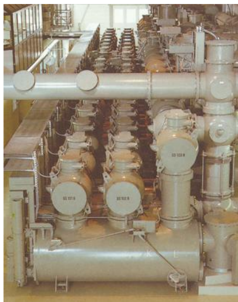
Obr. 10.6. – Zapouzdřená rozvodna 145 kV (SIEMENS)
