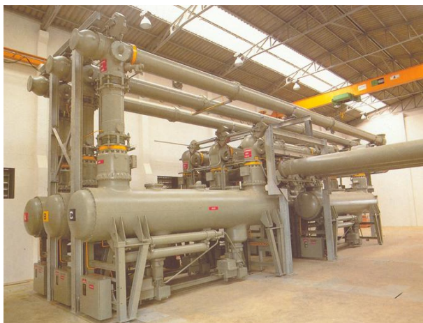
Obr. 10.6. – Zapouzdřená rozvodna 550 kV (SIEMENS)
